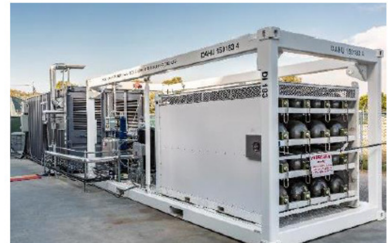
200 kW SOEC unit in Los Angeles, USA
